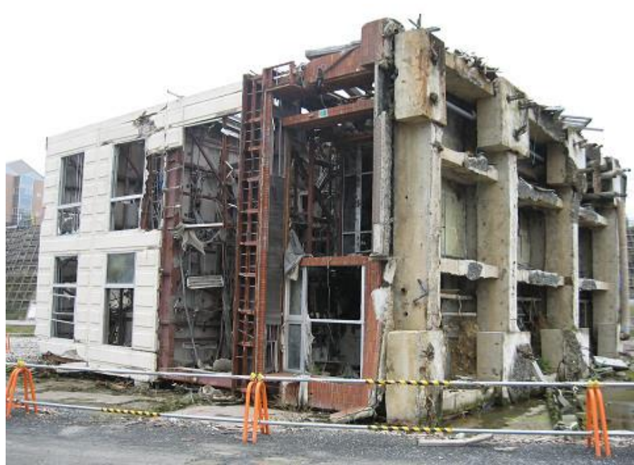
4階建ての建物が横転しています。右側が下で支柱が折れてしまっています。この他にもいくつかありました。
