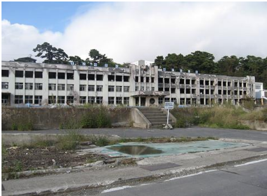
小学校ですが、火災が発生して焼け跡が付いています。 ここは、火災が発生した場所です。津波の上の火災(水上火災)なので、 上の部分だけ焼け跡があるのが特徴です。(特に左側)
